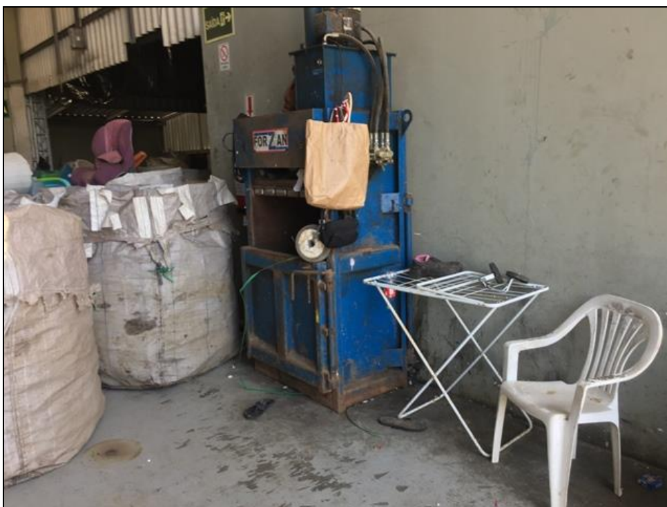
Figura 68 – Unidade de Reciclagem Santa Bárbara (prensa danificada) Fonte: Premier Engenharia, 2019.
