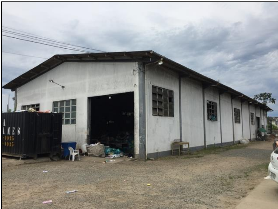
Figura 34 – Unidade de Reciclagem da RECICLA Fonte: Premier Engenharia, 2019.
