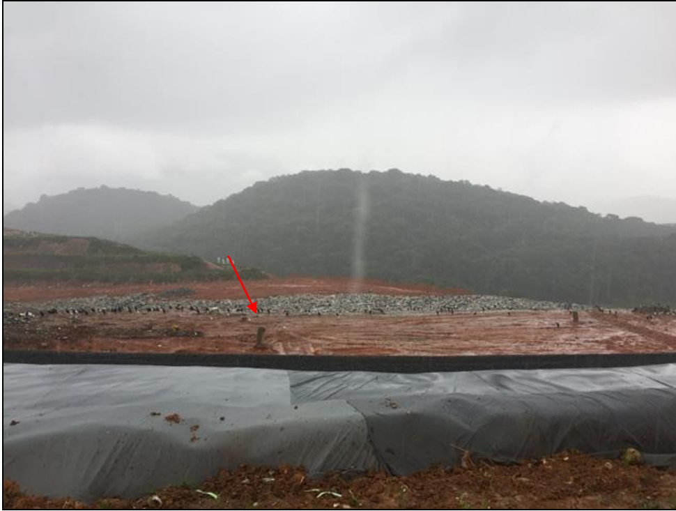
Figura 58 – Aterro sanitário municipal (dreno de gases)
